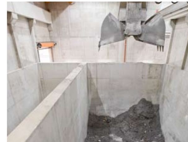
SCHLACKENBUNKER mit Krananlage SLAG BUNKER with crane system
