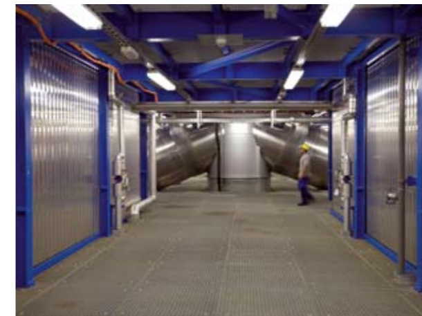
Zusammenführung beider Verbrennungslinien in den KAMIN Bonding of both incineration lines in one CHIMNEY
